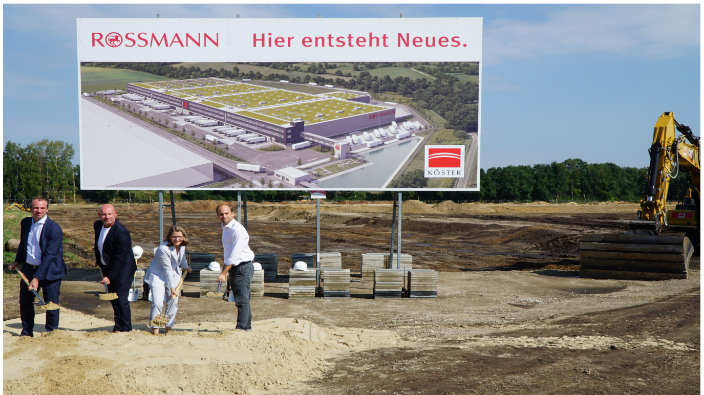
Setzen den ersten Spatenstich für das neue Logistikzentrum am Standort Burgwedel (v.l.n.r.): Nils Köster (Geschäftsführer Köster GmbH), Michael Rybak (Geschäftsführer Dirk Rossmann GmbH), Ortrud Wendt (Bürgermeisterin Burgwedel) und Raoul Roßmann (Geschäftsführer Dirk Rossmann GmbH)
